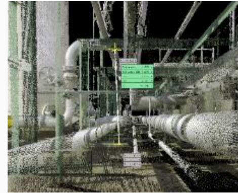
プラント配管計測
